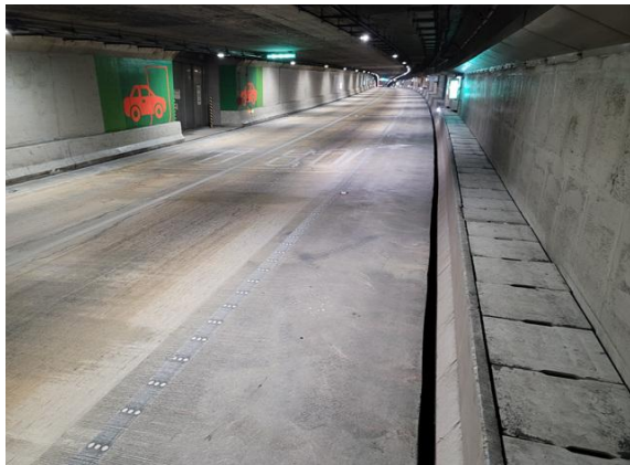
서부간선지하도로 내부 (BOX구간)
